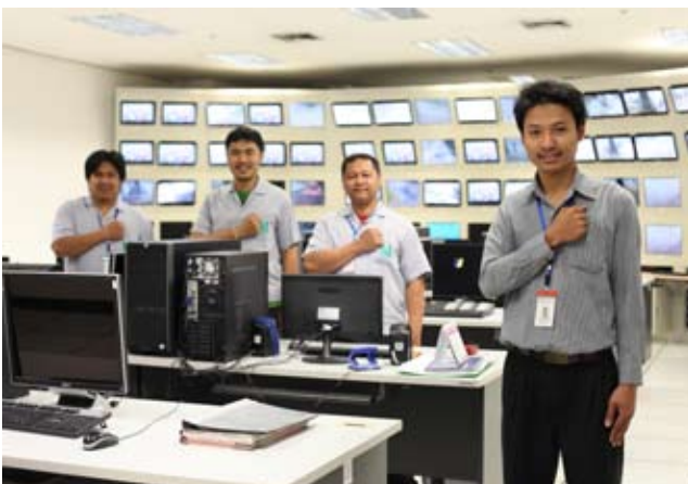
ห้องควบคุมของระบบ BAS
