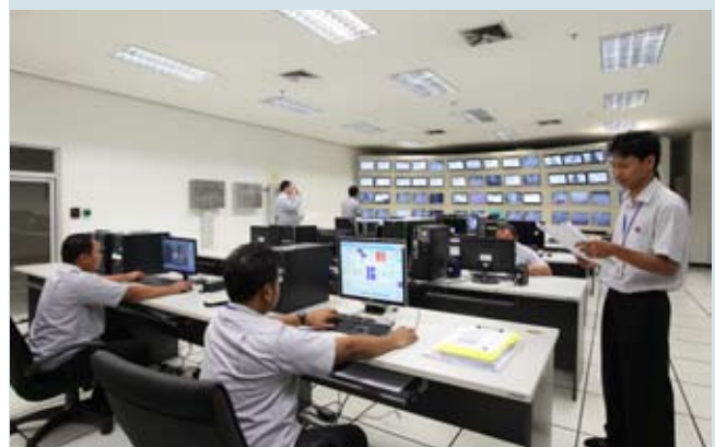
ห้องควบคุมของระบบ BAS
