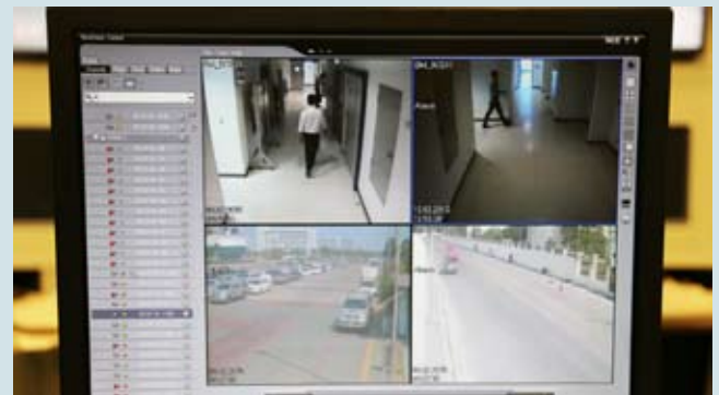
ระบบโทรทัศน์วงจรปิด (Closed Circuit Television System, CCTV)
