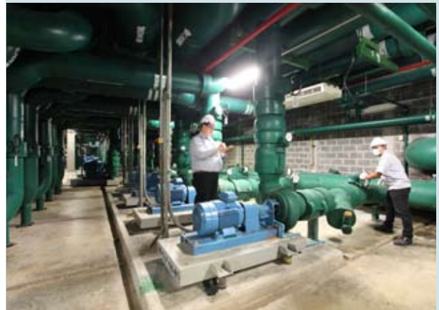
การบำรุงรักษาเชิงป้องกันปั๊มส่งจ่ายน้ำเย็น สำหรับระบบปรับอากาศ
