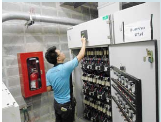
ตรวจสอบระบบควบคุมไฟฟ้าหลัก
