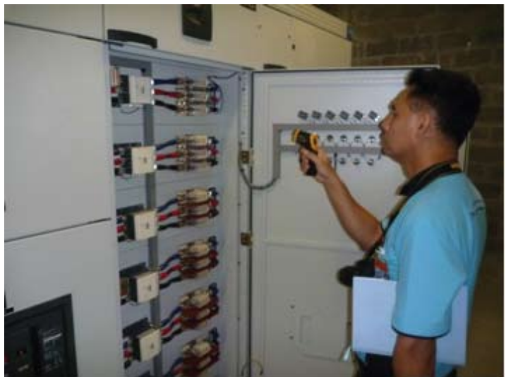
ตรวจสอบตู้ควบคุมไฟฟ้าหลัก
