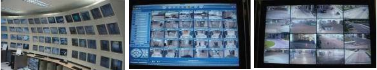
ระบบโทรทัศน์วงจรปิด(Closed Circuit Television System, CCTV)
